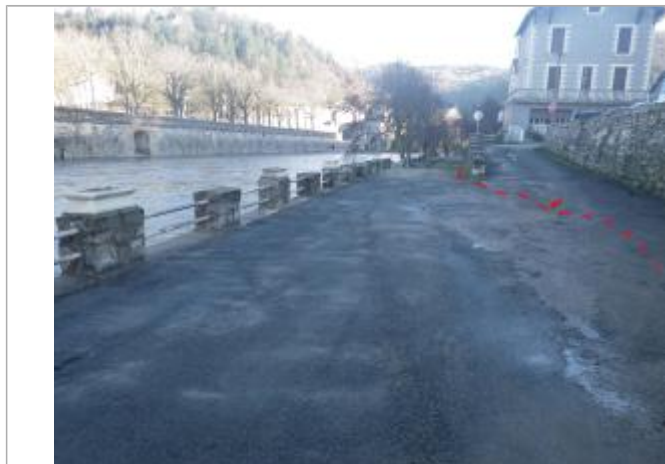
Vue de la laisse d'inondation - Auteur : AGERIN
