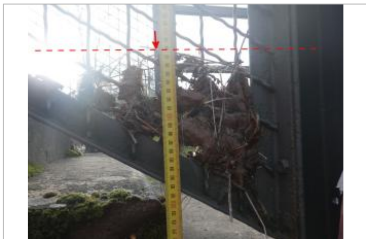
Vue de la laisse d'inondation - Auteur : AGERIN
