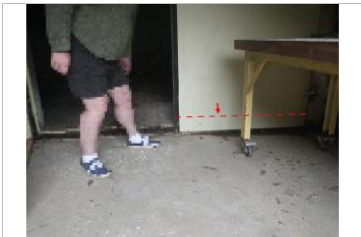
Vue de la laisse d'inondation - Auteur : AGERIN
