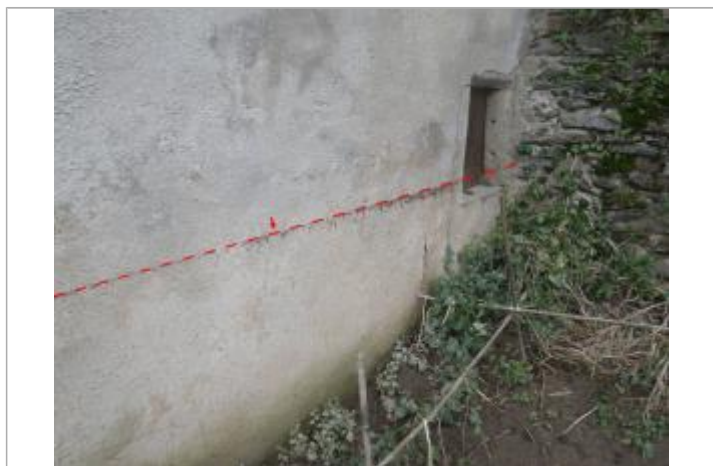
Vue de la laisse d'inondation - Auteur : AGERIN
