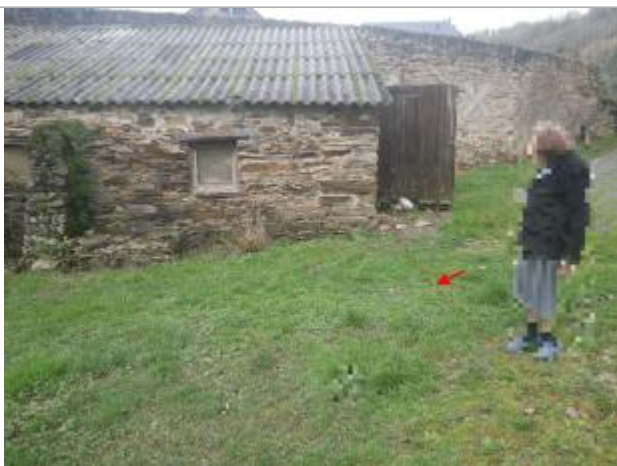
Vue de la laisse d'inondation - Auteur : AGERIN
