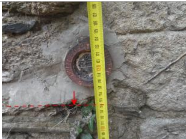
Vue de la laisse d'inondation - Auteur : AGERIN
