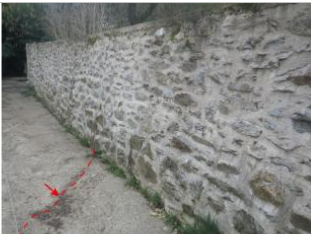
Vue de la laisse d'inondation - Auteur : AGERIN
