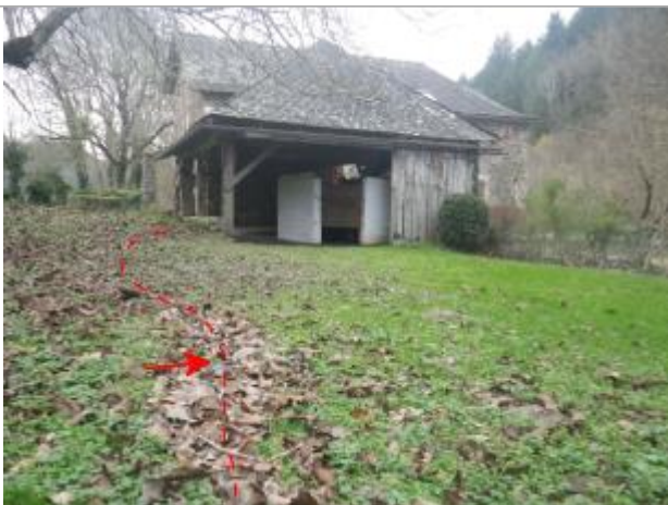
Vue de la laisse d'inondation - Auteur : AGERIN
