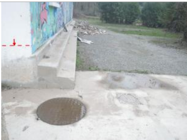
Vue de la laisse d'inondation - Auteur : AGERIN
