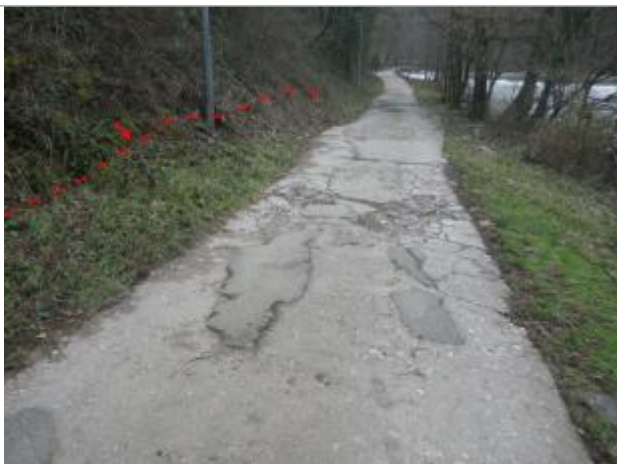
Vue de la laisse d'inondation - Auteur : AGERIN
