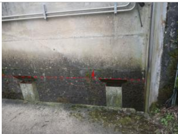
Vue de la laisse d'inondation - Auteur : AGERIN
