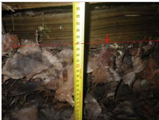
Vue de la laisse d'inondation - Auteur : AGERIN
