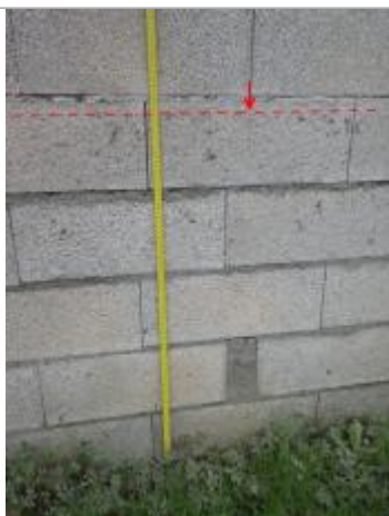
Vue de la laisse d'inondation - Auteur : AGERIN
