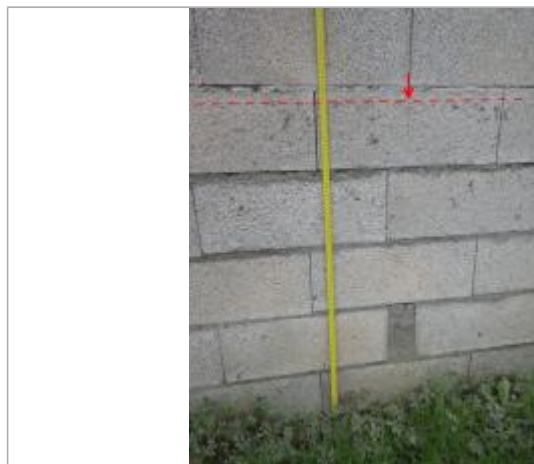
Vue de la laisse d'inondation - Auteur : AGERIN
