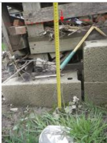
Vue de la laisse d'inondation - Auteur : AGERIN
