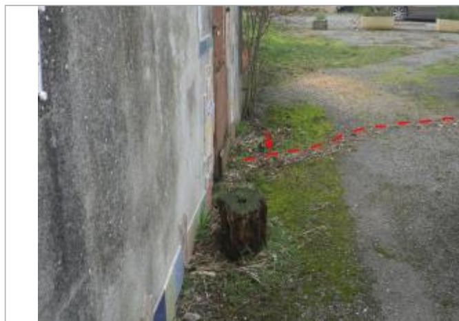
Vue de la laisse d'inondation - Auteur : AGERIN
