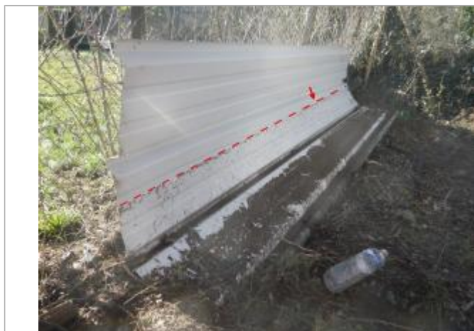
Vue de la laisse d'inondation - Auteur : AGERIN
