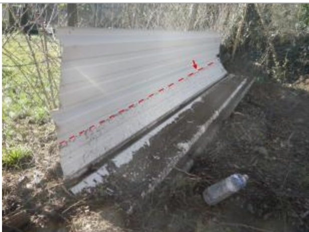
Vue de la laisse d'inondation - Auteur : AGERIN
