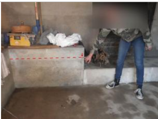
Vue de la laisse d'inondation - Auteur : AGERIN
