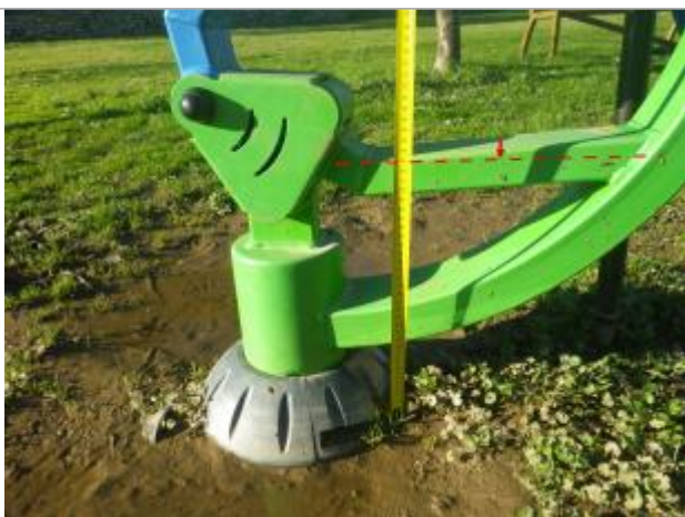
Vue de la laisse d'inondation - Auteur : AGERIN
