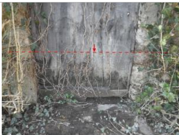
Vue de la laisse d'inondation - Auteur : AGERIN
