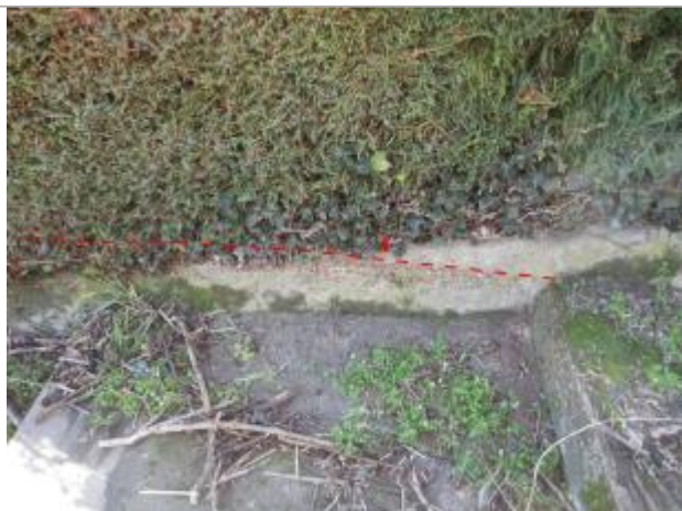
Vue de la laisse d'inondation - Auteur : AGERIN
