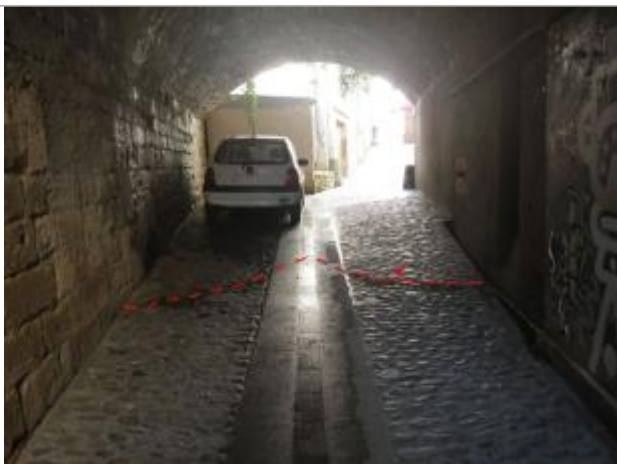
Vue de la laisse d'inondation - Auteur : AGERIN
