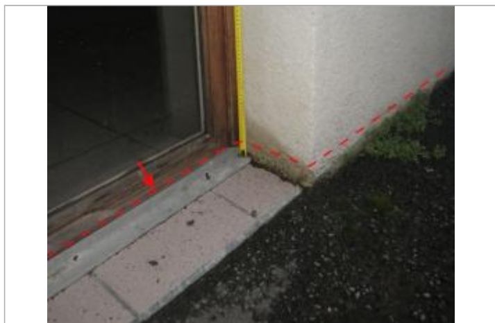
Vue de la laisse d'inondation - Auteur : AGERIN
