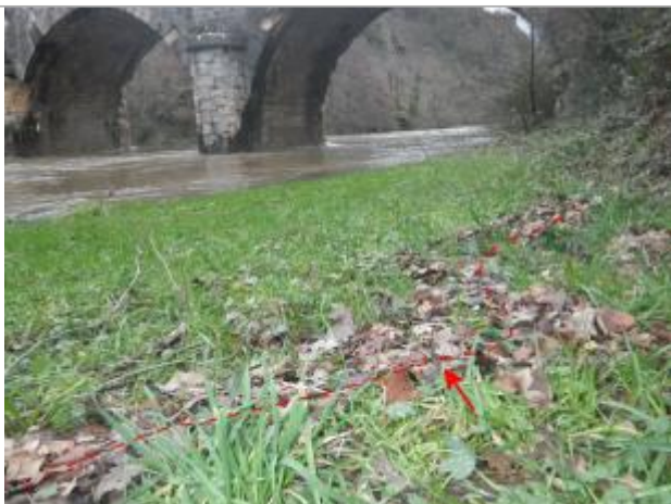
Vue de la laisse d'inondation - Auteur : AGERIN
