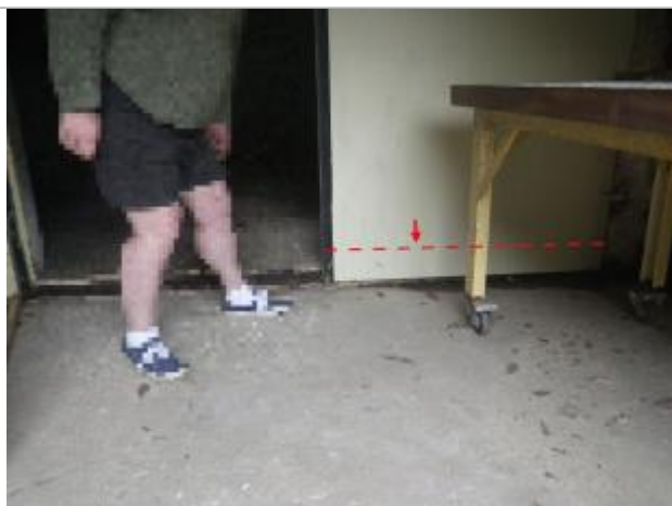
Vue de la laisse d'inondation - Auteur : AGERIN
