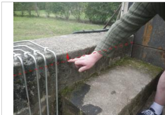
Vue de la laisse d'inondation - Auteur : AGERIN
