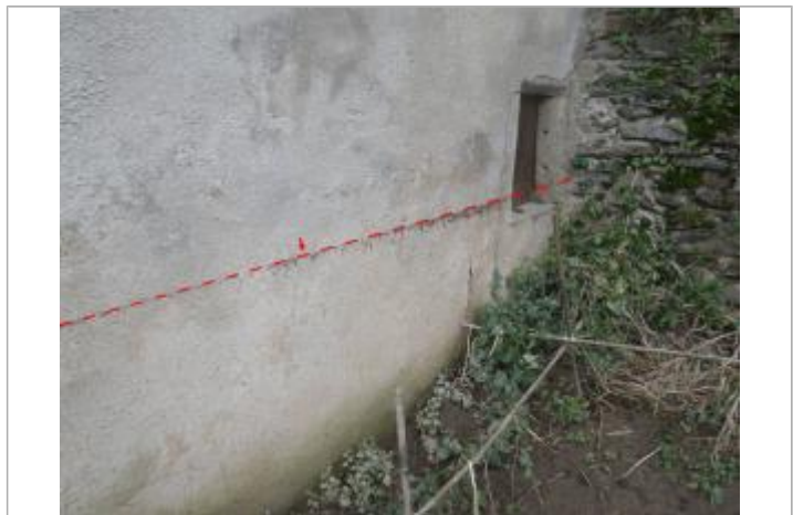
Vue de la laisse d'inondation - Auteur : AGERIN
