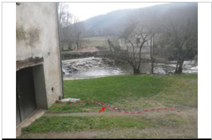
Vue de la laisse d'inondation - Auteur : AGERIN
