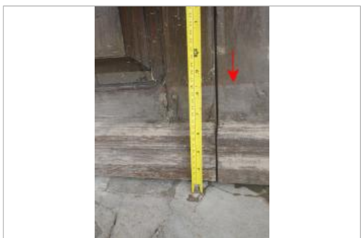
Vue de la laisse d'inondation - Auteur : AGERIN
