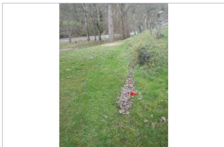
Vue de la laisse d'inondation - Auteur : AGERIN
