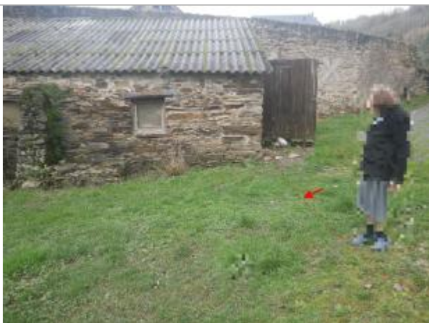
Vue de la laisse d'inondation - Auteur : AGERIN
