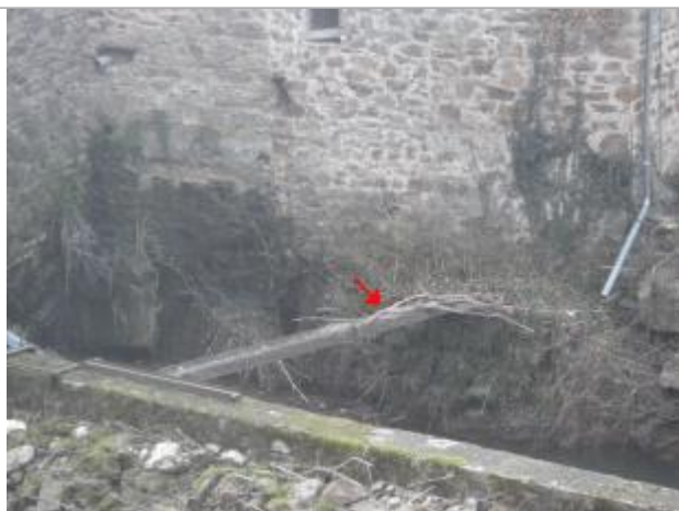
Vue de la laisse d'inondation - Auteur : AGERIN
