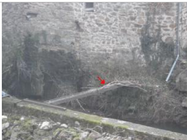
Vue de la laisse d'inondation - Auteur : AGERIN
