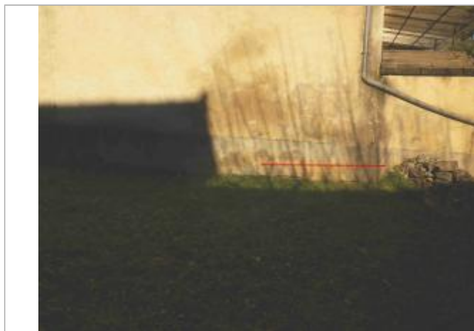
Vue de la laisse d'inondation - Auteur : GEOSPHAIR
