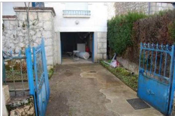
Vue de la laisse d'inondation - Auteur : GEOSPHAIR
