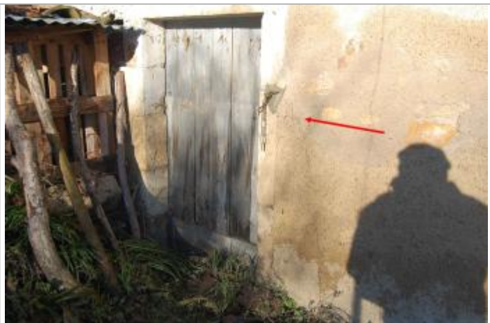
Vue de la laisse d'inondation - Auteur : GEOSPHAIR
