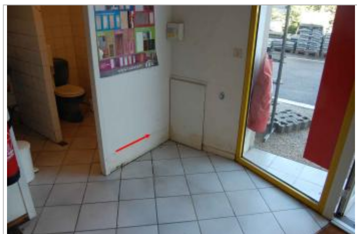
Vue de la laisse d'inondation - Auteur : GEOSPHAIR
