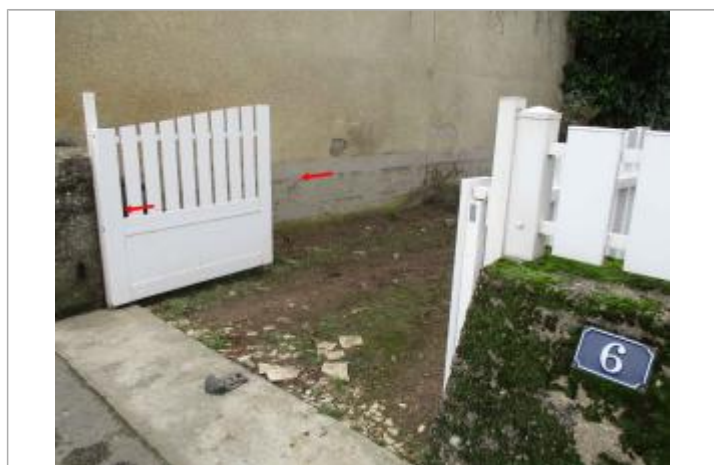
Vue de la laisse d'inondation - Auteur : DDT46
