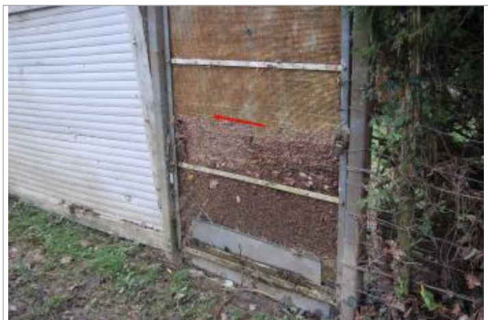
Vue de la laisse d'inondation - Auteur : GEOSPHAIR
