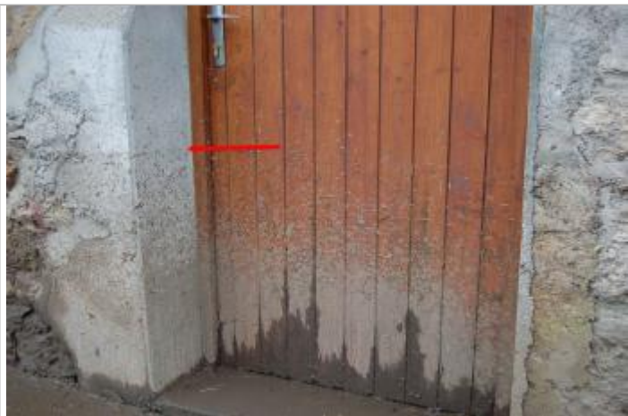
Vue de la laisse d'inondation - Auteur : GEOSPHAIR
