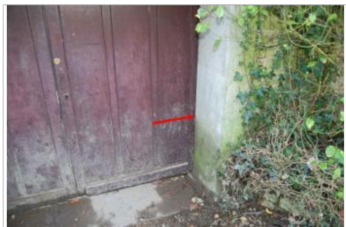
Vue de la laisse d'inondation - Auteur : GEOSPHAIR
