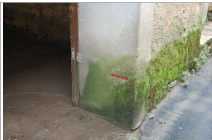
Vue de la laisse d'inondation - Auteur : GEOSPHAIR
