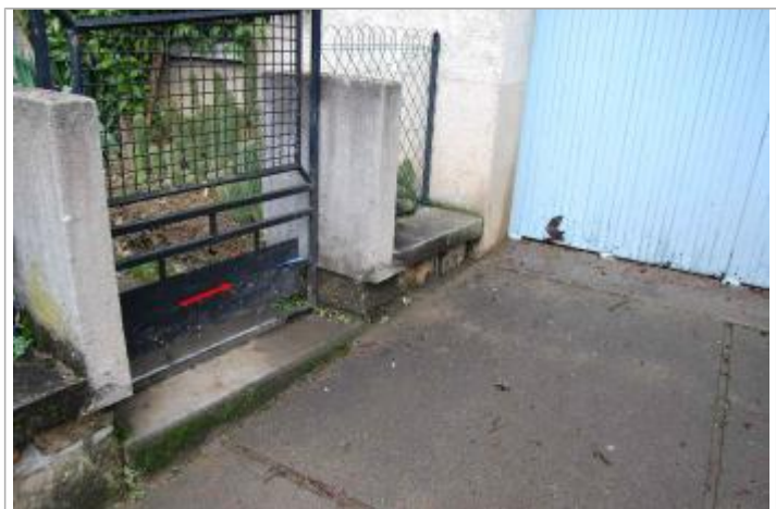
Vue de la laisse d'inondation - Auteur : GEOSPHAIR
