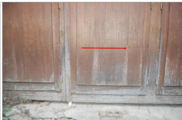
Vue de la laisse d'inondation - Auteur : GEOSPHAIR
