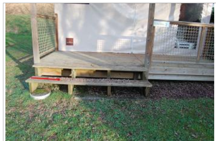
Vue de la laisse d'inondation - Auteur : GEOSPHAIR
