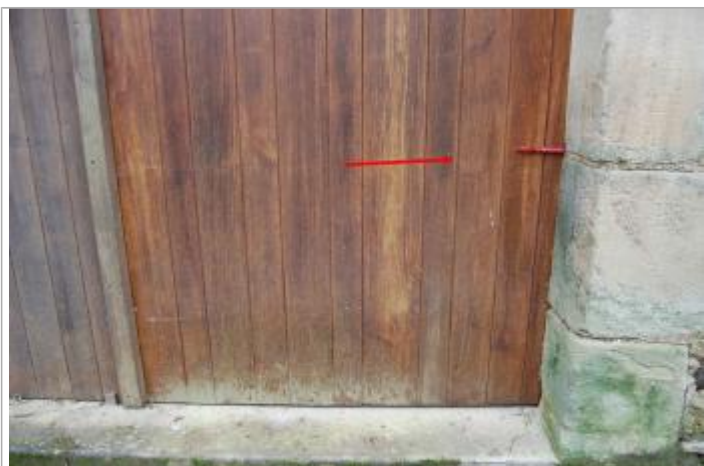
Vue de la laisse d'inondation - Auteur : GEOSPHAIR
