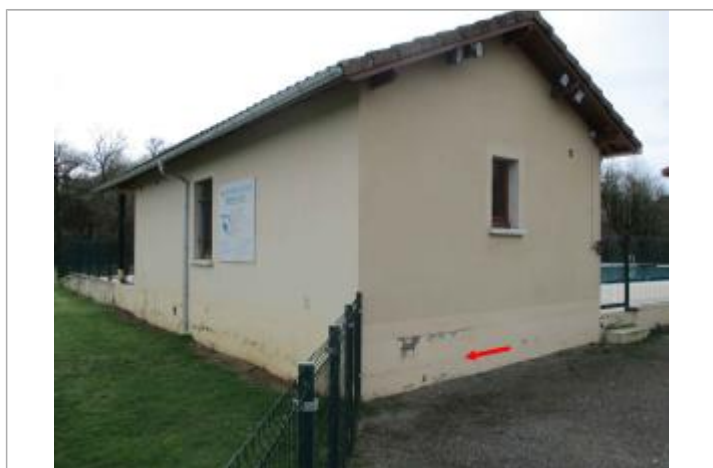
Vue de la laisse d'inondation - Auteur : DDT46
