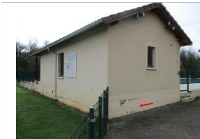
Vue de la laisse d'inondation - Auteur : DDT46
