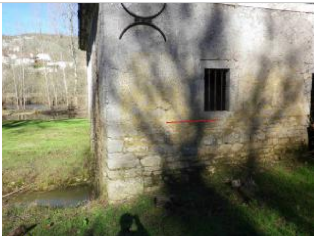
Vue de la laisse d'inondation - Auteur : GEOSPHAIR
