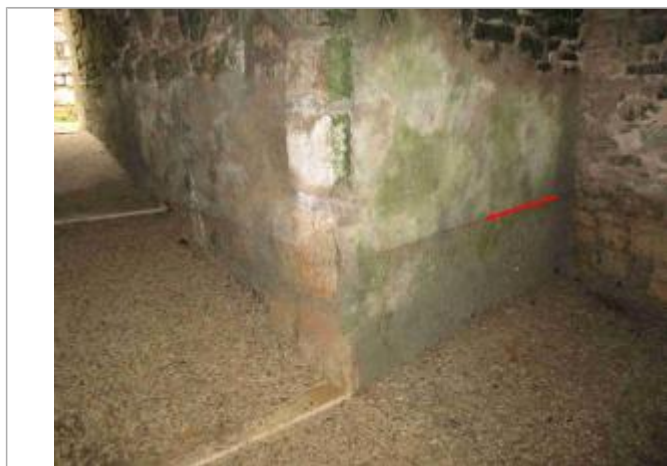
Vue de la laisse d'inondation - Auteur : DDT46
