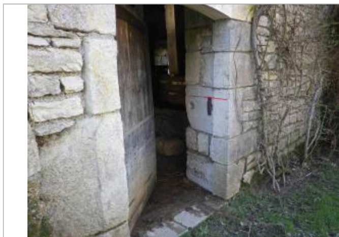
Vue de la laisse d'inondation - Auteur : GEOSPHAIR
