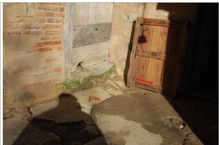
Vue de la laisse d'inondation - Auteur : GEOSPHAIR
