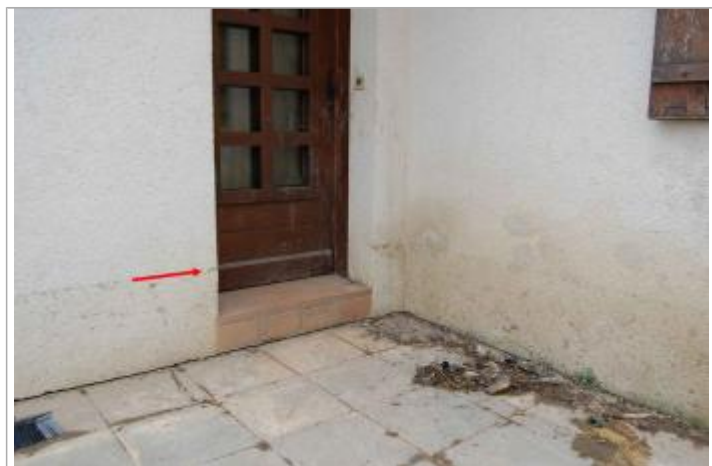
Vue de la laisse d'inondation - Auteur : GEOSPHAIR
